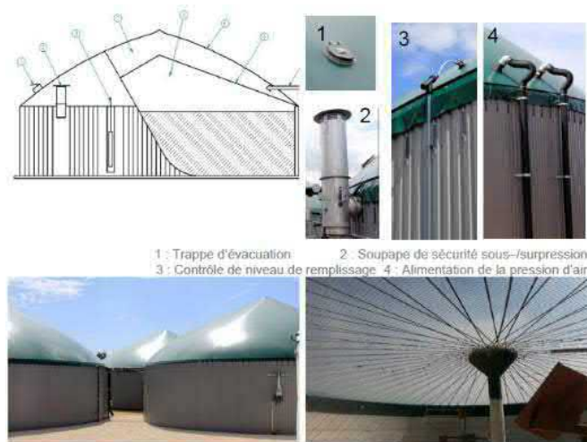
Figure 10. Photos des gazomètres
