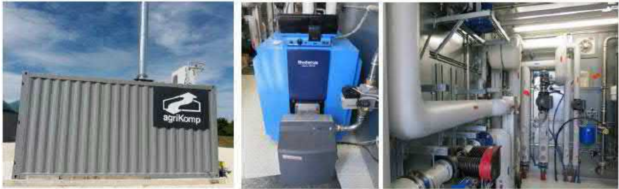
Figure 18. Photographies de la chaudière
