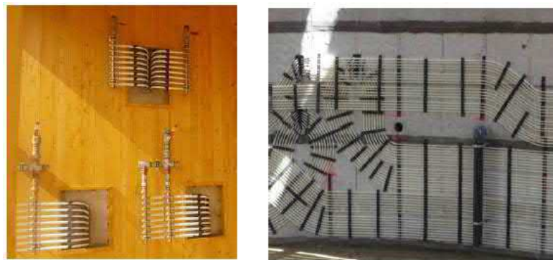
Figure 7. Système de chauffage des fosses process
