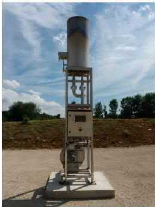
Figure 19. Photographie de la torchère
